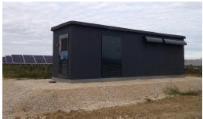
Poste de transformation
