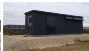
Poste de maintenance
