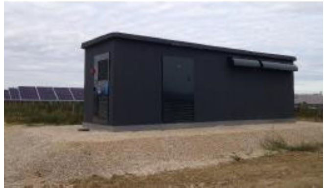
Poste de transformation
